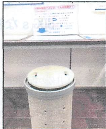
雨水浸透マス
