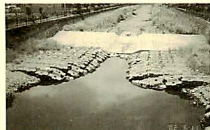
野塩橋の落差工に溜まった水
